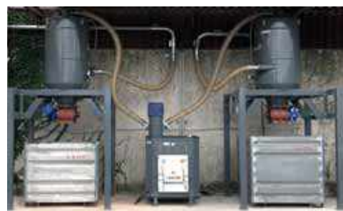
Beispiel: Filter-Vorabscheider mit Zellenradschleuse
